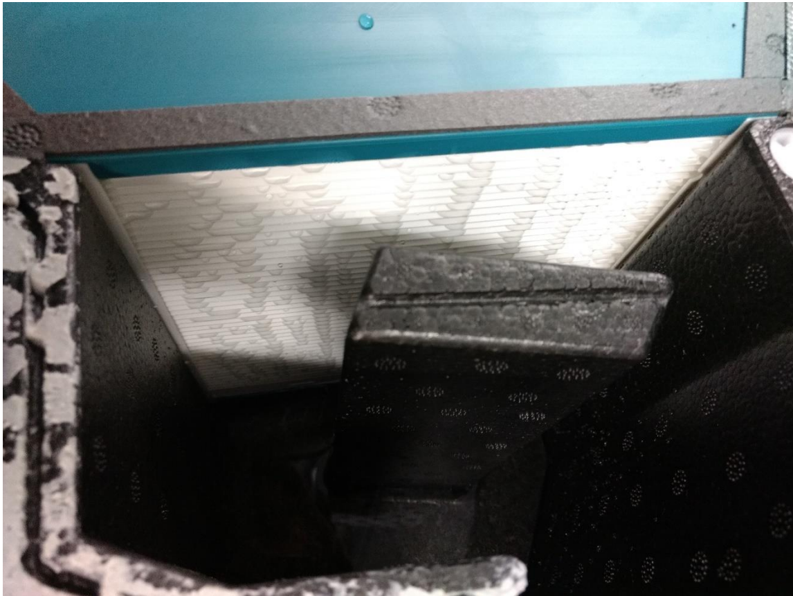
Abbildung 3: Fortluft nach dem Wärmeübertrager (Kondensatwanne)
