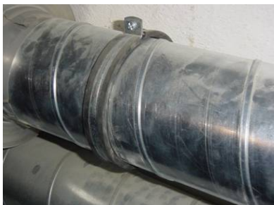
Abbildung 8: Befestigung mit Gummimanschette (Foto stammt noch aus der Bauphase, daher sind die Rohre noch ohne Dämmung ausgeführt)
