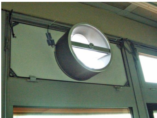
Abb. 37 Lüftungsgerät Typ D
