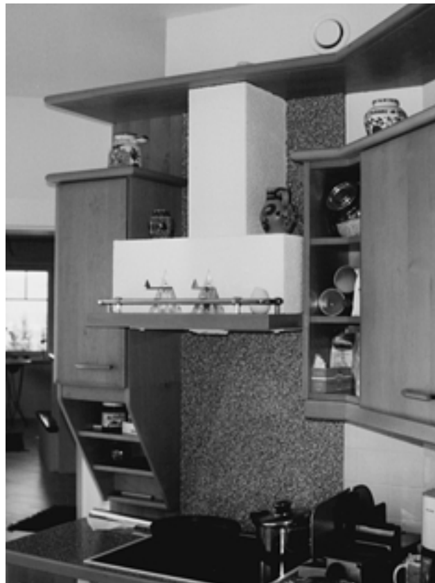
Abb. 15: Dunstabzugshaube mit Umluft und darüberliegende Absaugung durch die Lüftungsanlage
