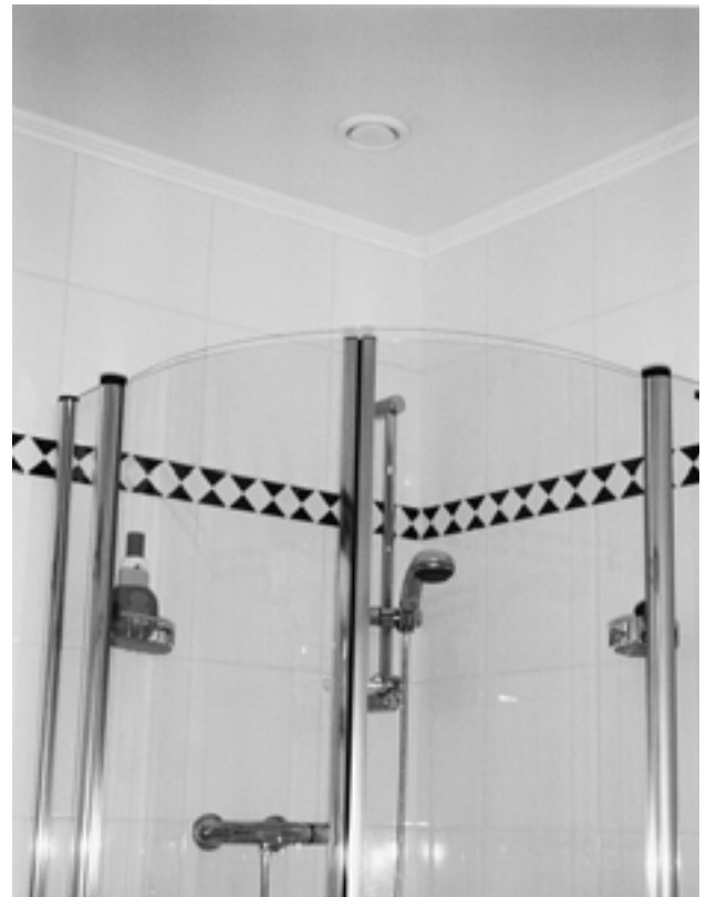
Abb. 5: Abluftventil im Bad
