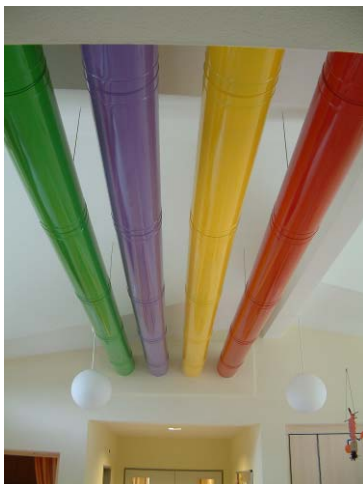
Abbildung 1.1: Beispiel einer gelungenen Integration von Luftleitungen in einem Kindergarten
